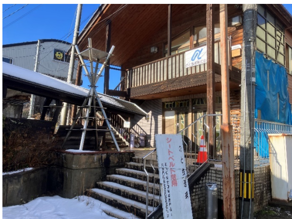
のと鉄道の穴水駅事務所。ブルーシートが貼られ、手前の通路は真いたまま
